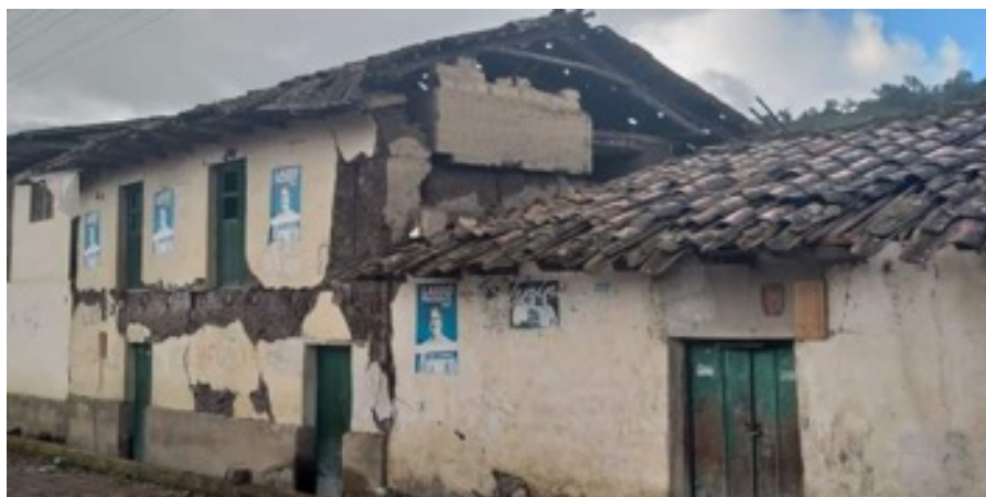
4.9 Casa afectada por terremoto en La Libertad – Cantón Espejo
