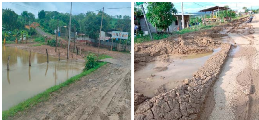
Carretera destruida Foto: Ferdinand Muñoz
