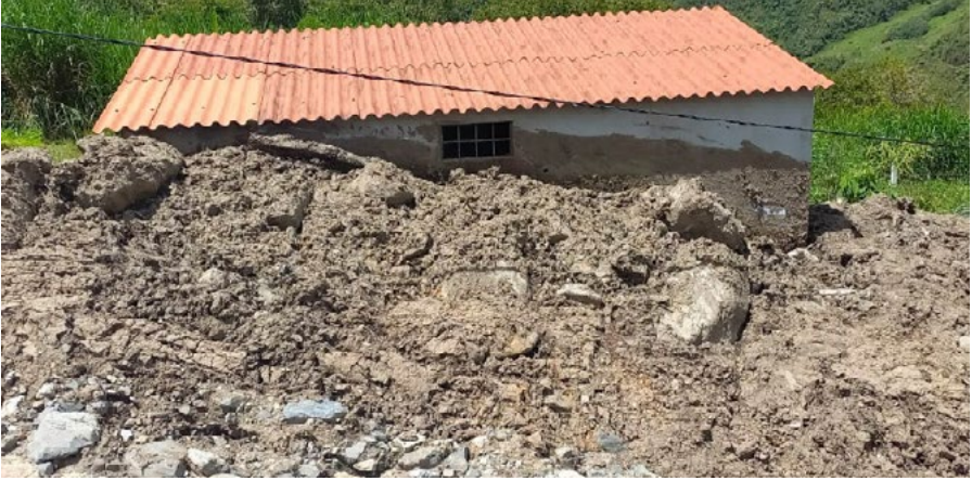
2.3 Casa afectada por el deslave
