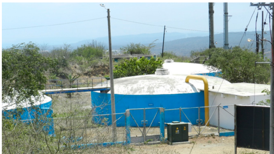
Figura 5 Planta de tratamiento de agua potable Centinela Fuente: Archivo del autor (2024)
